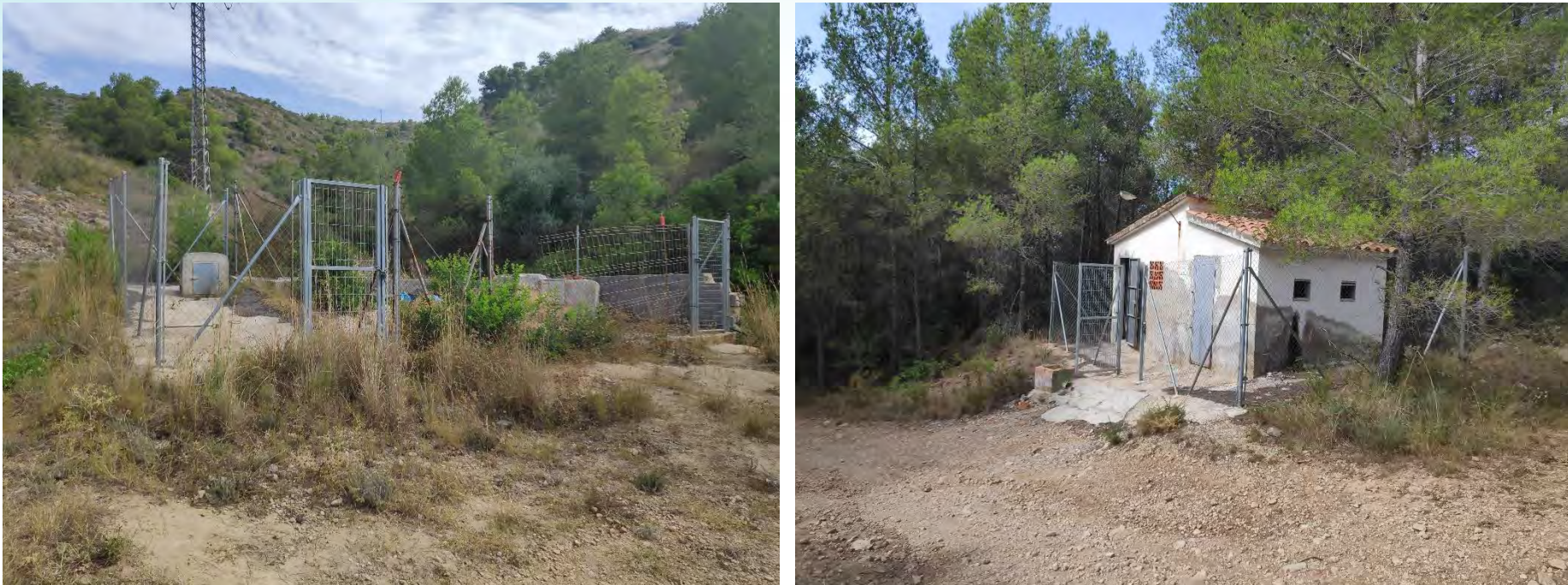
Figura 18. Pou Cal Llorenç. Vista general. Pou i caseta de telecontrol i cloració.
