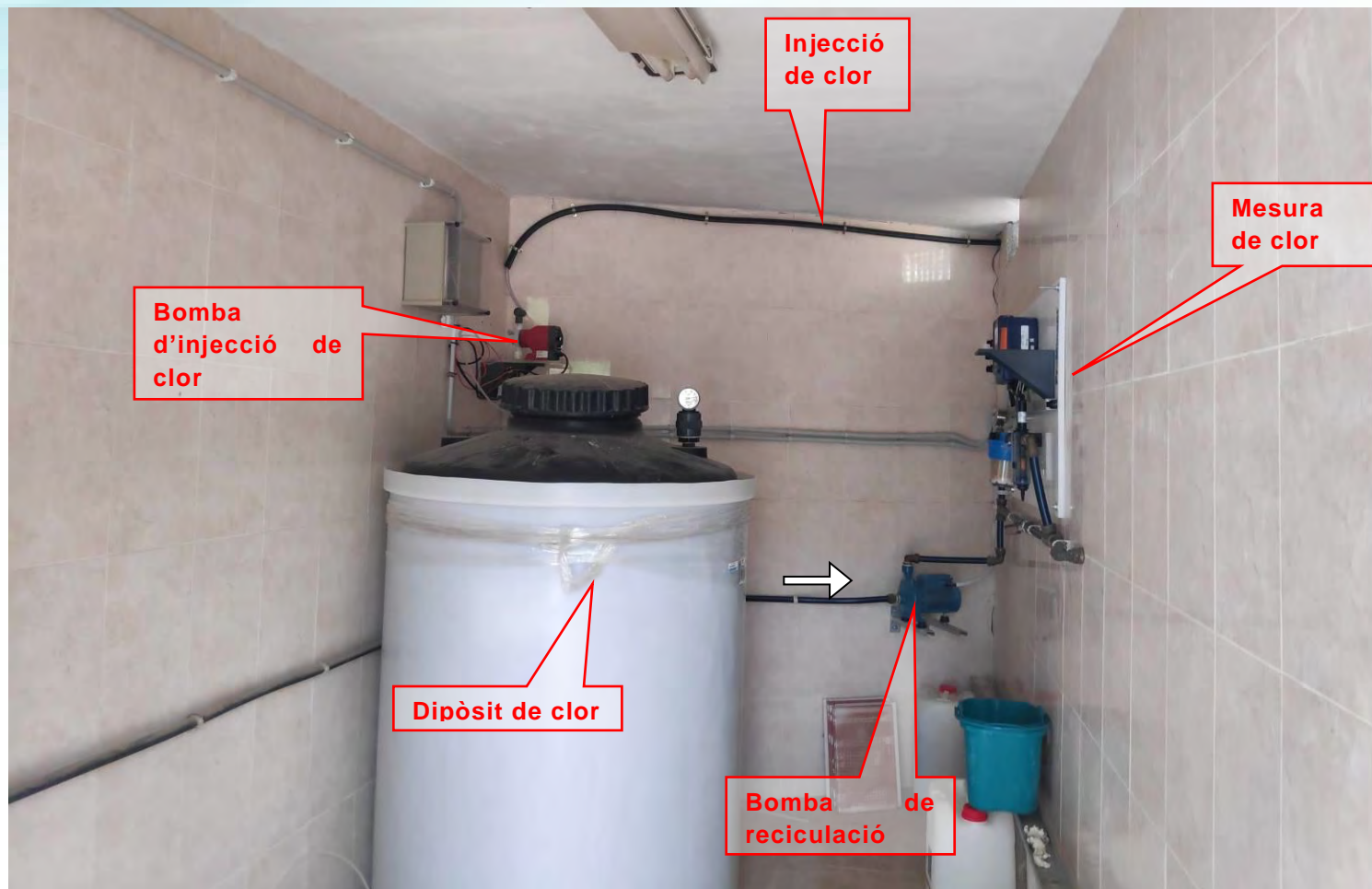
Figura 6. Dipòsit Molí Cucurull. Sala cloració. Vista general.
