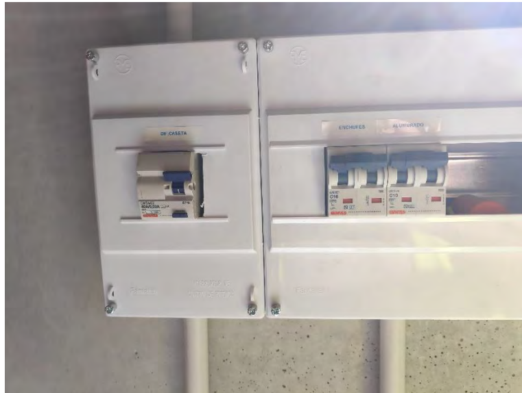
Figura 14 Quadre de protecció de la caseta.
