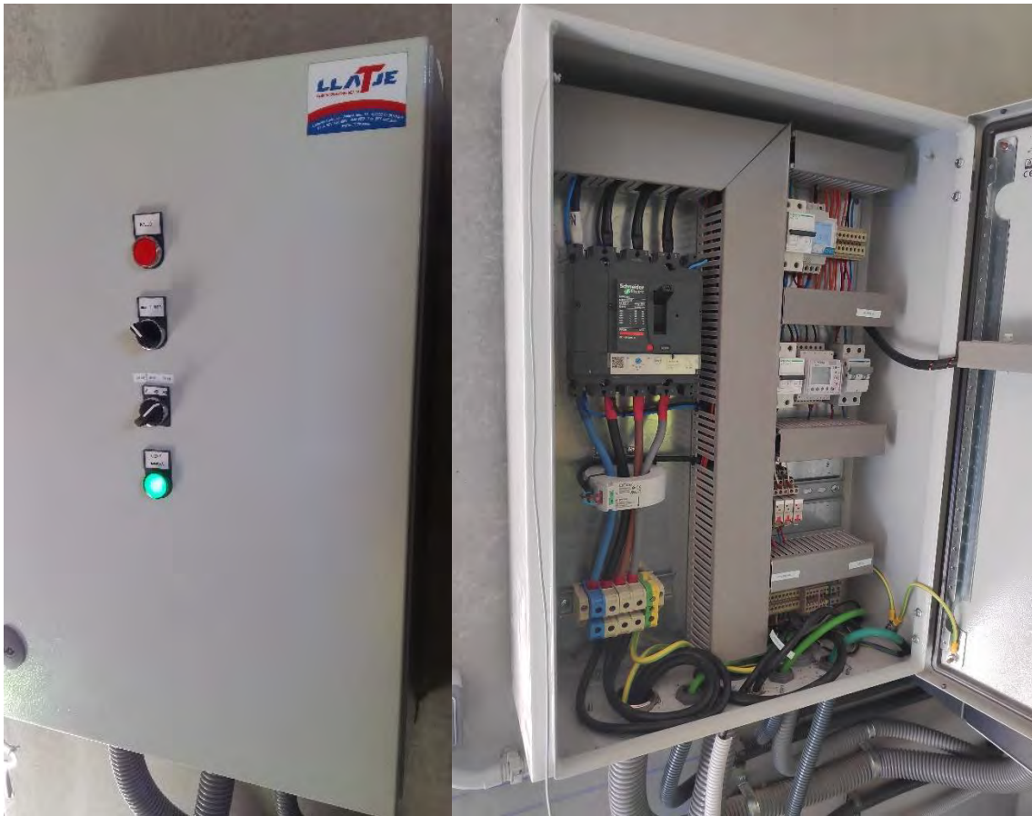
Figura 12 Quadre de control i protecció.
