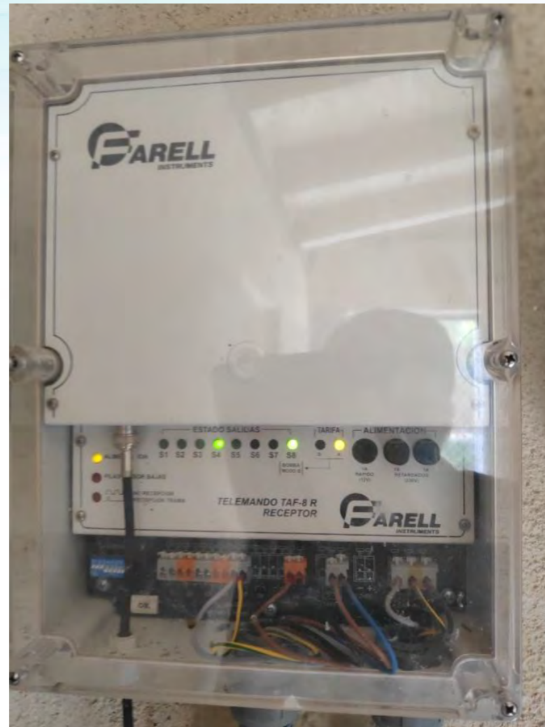
Figura 20. Pou Cal Llorenç. Caseta de telecontrol. Sistema de telecontrol.
