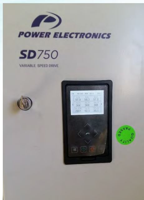
Figura 13 Variador de freqüència.
