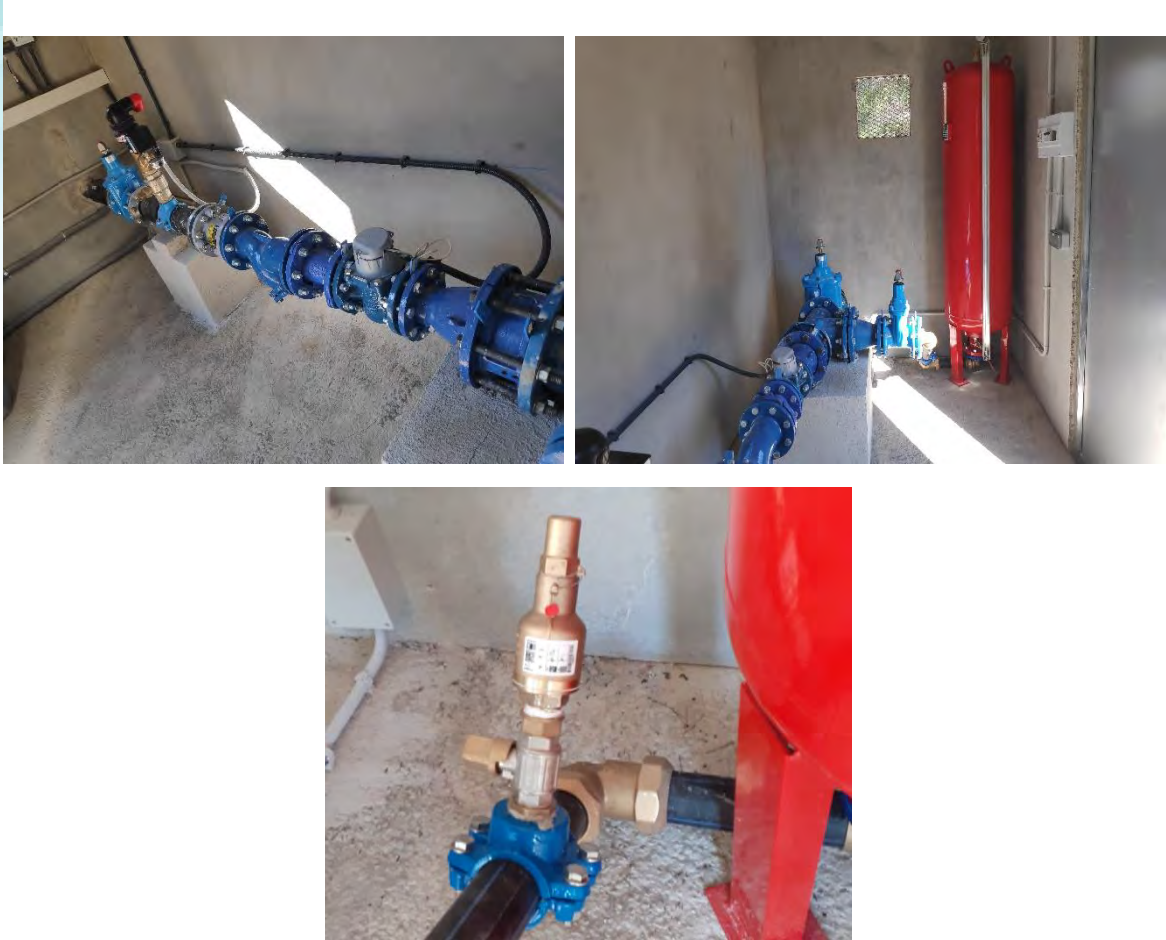
Figura 11 Vista general dels equipaments hidràulics.
